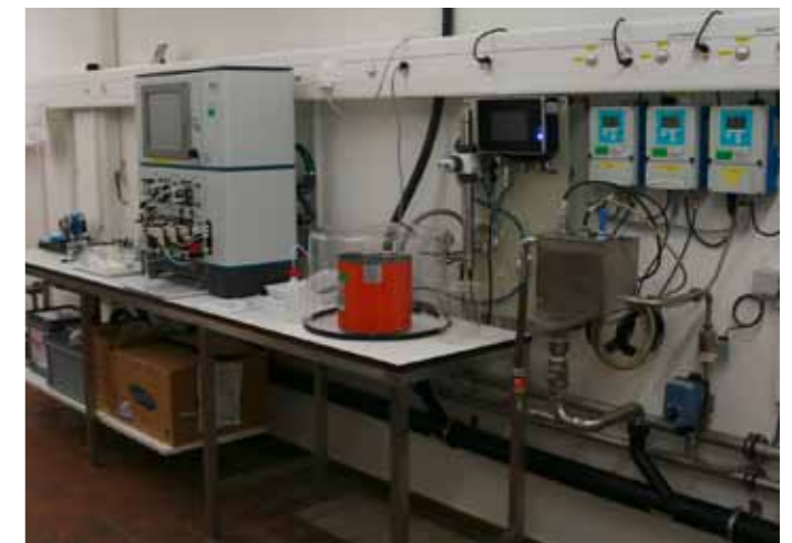
Abb. 5: Messraum mit der Online-Rohwasseranalytik.
