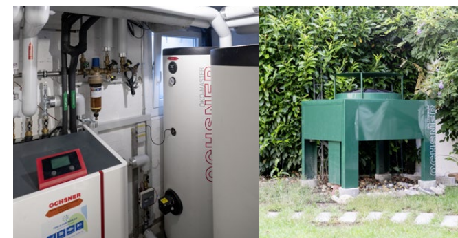
Luft-Wasser-Wärmepumpe, Heizanlage und Ausseneinheit
