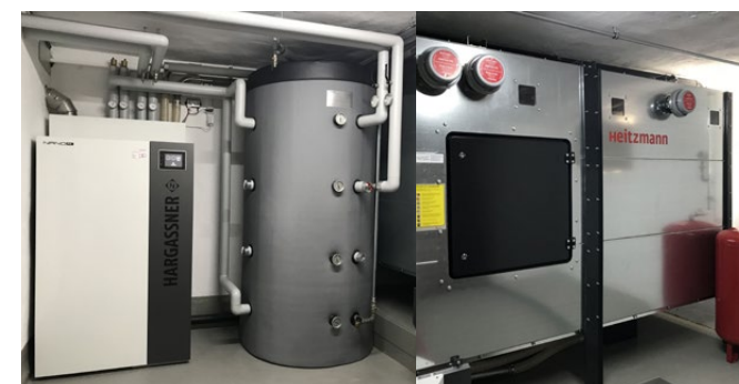
Pelletheizanlage und Pelletspeicher
