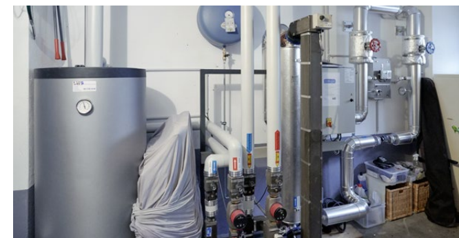
Fernwärmeübergabestation und Warmwasserspeicher
